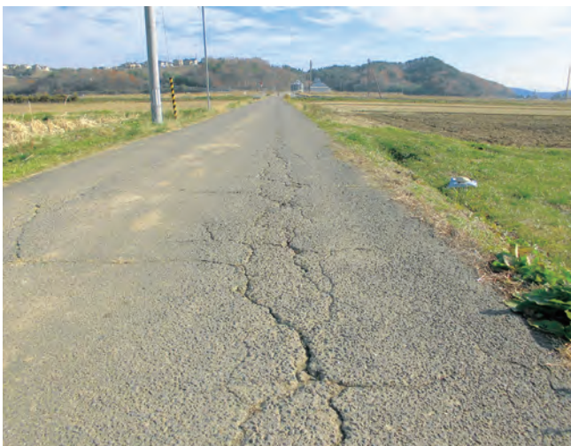
▲傷んだ道路はいち早く修繕すべき (写真は岩根・北原田線)
