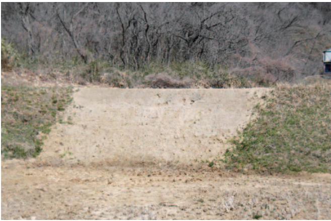
▲台風により被害を受けた農地
