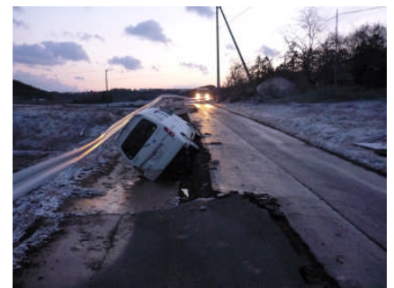
青田地区道路陥没
