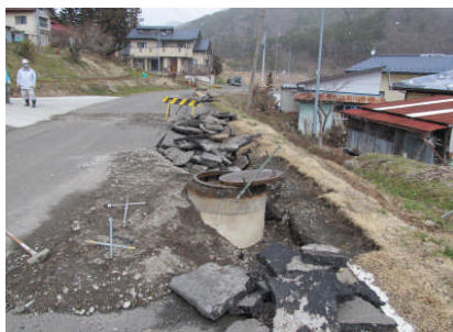
青田地区の下水道管隆起
