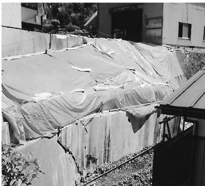
豪雨により住宅隣接地で法面が崩壊した現場（和田地区）
