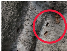
▲写真③脱出痕
