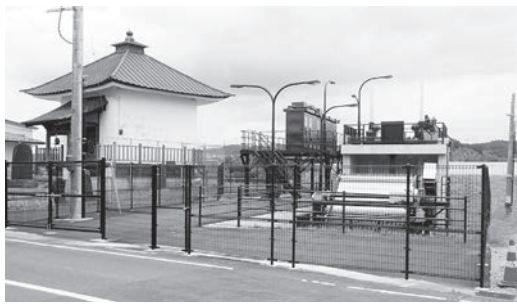
太郎丸地内に整備した排水ポンプ場
