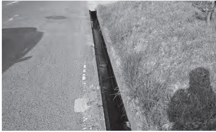
側溝内の土砂はまだ線量が高い
