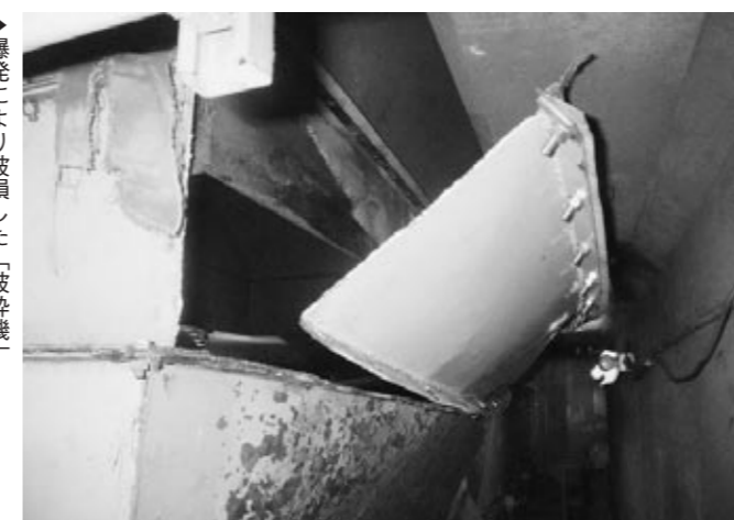
▶爆発により破損した「破砕機」
