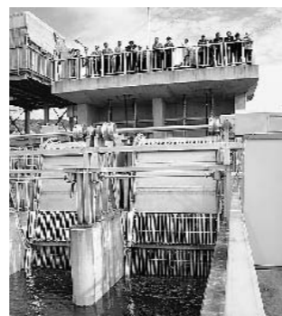
東町排水ポンプ場試運転 水害発生時に命と財産を守ります
